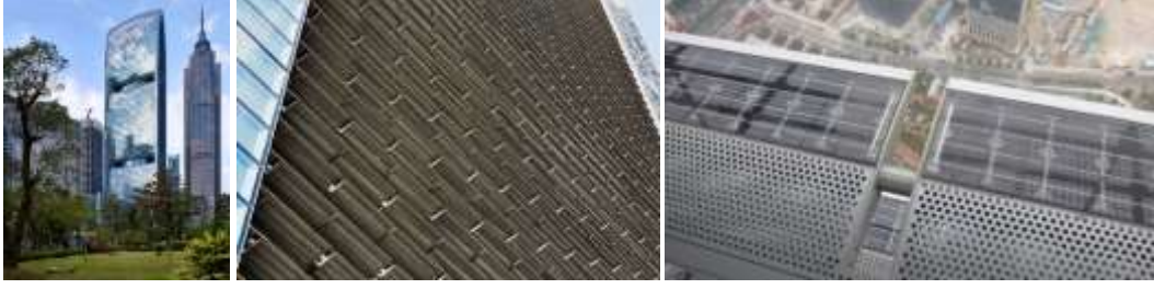
Şekil 10. Pearl Nehri Kulesi cephesinde kullanılan fotovoltaik paneller
